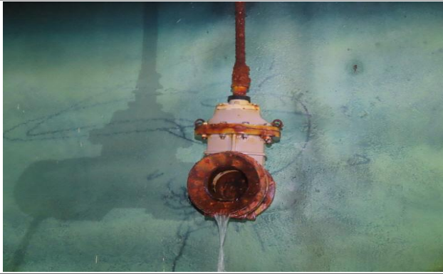
배수지 1지 유입 배관 관부식
