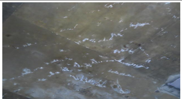
배수지 1지 상부슬래브 백태
