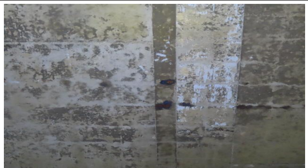
배수지 1지 상부슬래브 철근노출
