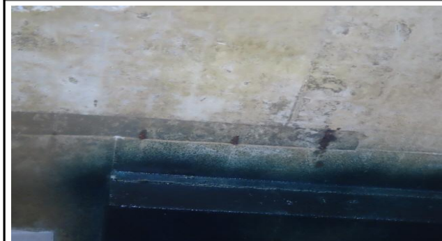
배수지 1지 상부슬래브 철근노출
