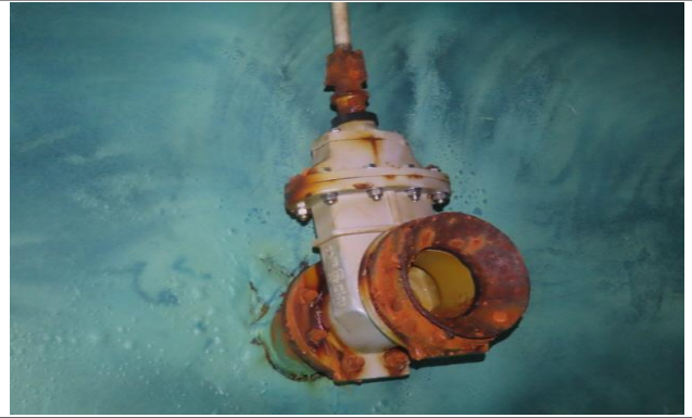
배수지 2지 유입 배관 관부식
