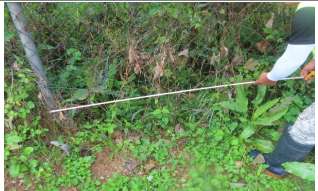
부재 손상 제원측정
